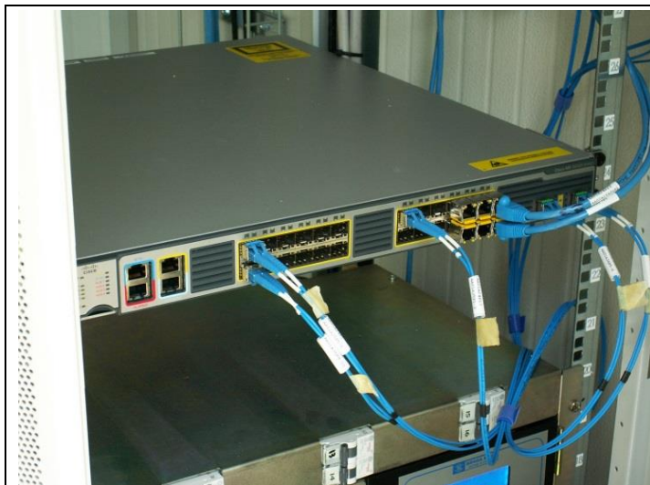
Particolare apparati in SHELTER presso sede del municipio di Barcis
