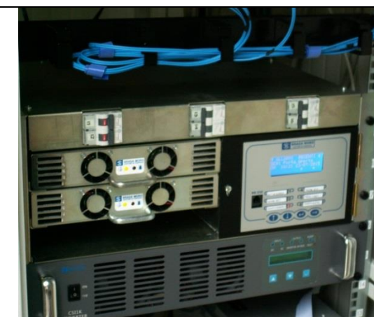
Apparati interni SHELTER - Cimolais
